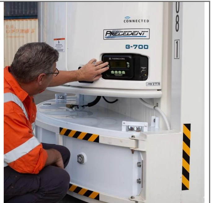
Ein Mitarbeiter bedient einen Kühlcontainermotor.
