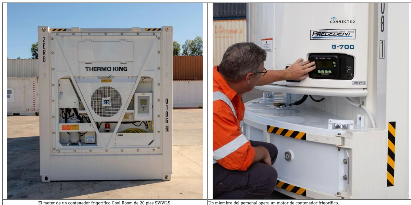
El motor de un contenedor frigorífico Cool Room de 20 pies SWLS.
